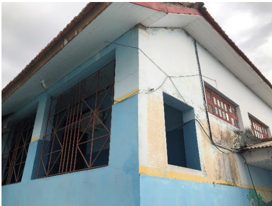
Figura 11 – Instalação Elétrica Aparente
