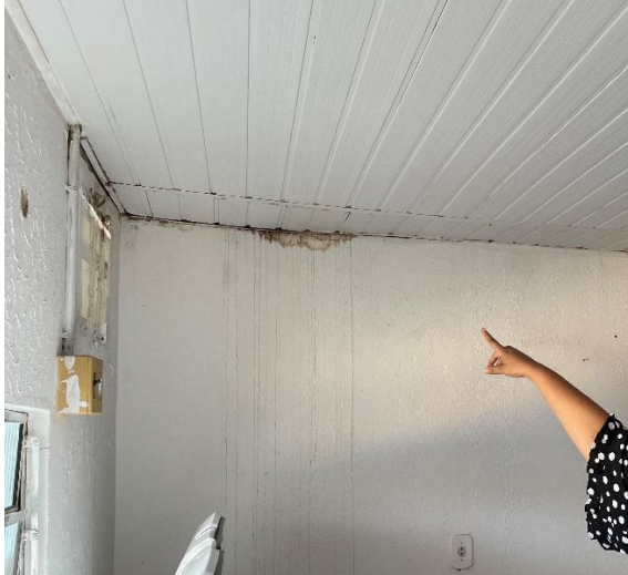
Figura 09 – Sujeira no Forro
