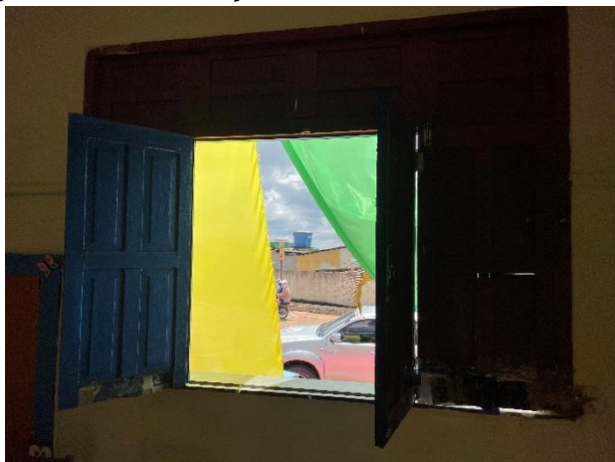
Figura 01 – Danificação nas Janelas
