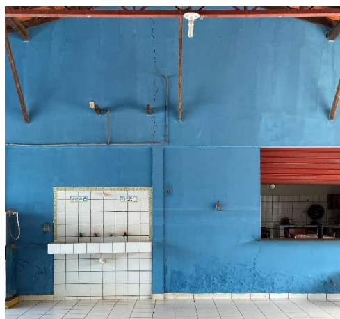
Figura 02 – Infiltração e Trincas nas Alvenarias
