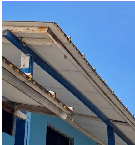
Figura 03 – Falta de acabamento na telha
