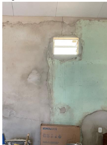
Figura 02 – Trinca em alvenaria.
