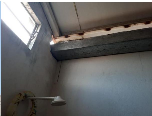
Figura 04 – Calha aparente em banheiro infantil.
