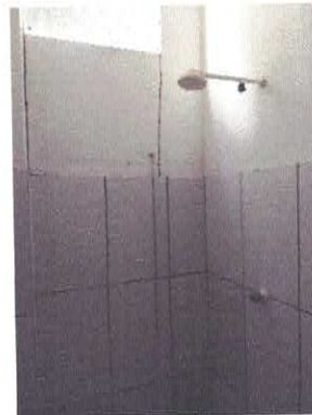
Foto 06 – Vista de chuveiro.
