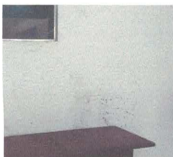
Foto 26 – Mofos na parede.
