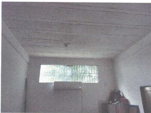
Foto 39 – Janela fixa, em vidro, não permite a ventilação.
