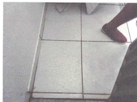
Foto 13 – Piso cerâmico sem rejunte.
