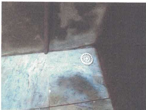
Foto 12 – Piso cerâmico na área de ventilação, sem rodapé.
