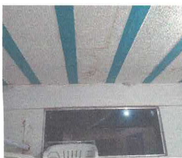
Foto 27 – Manchas na parede e teto.
