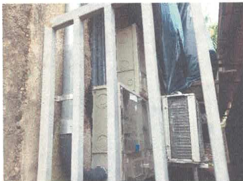
Foto 21 – Medidores e distribuição.
