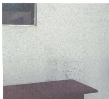
Foto 26 – Mofos na parede.
