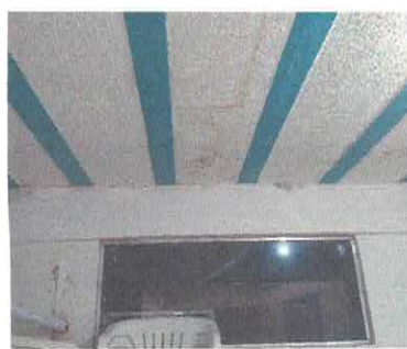
Foto 27 – Manchas na parede e teto.
