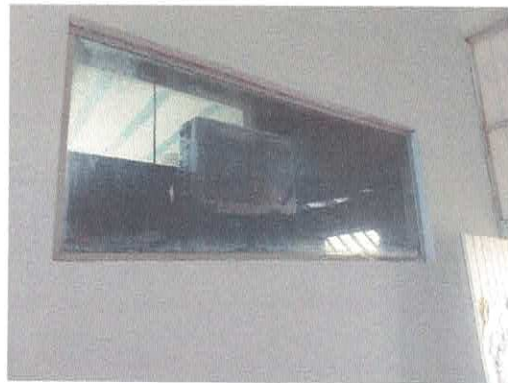
Foto 38 – Janela fixa, em vidro, não permite ventilação.
